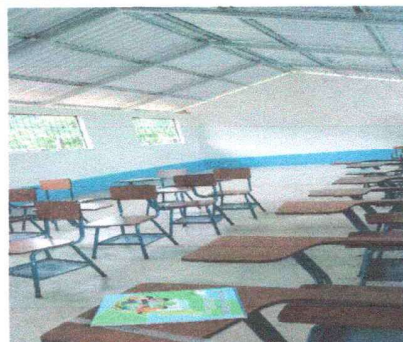
Foto 2: ASI SE OBSERVA DESDE EL INTERIOR DE LA ESCUELA, Y ASI MISMO SE PUEDE APRECIAR LA ESTRUCTURA DEL ENTECHADO.
